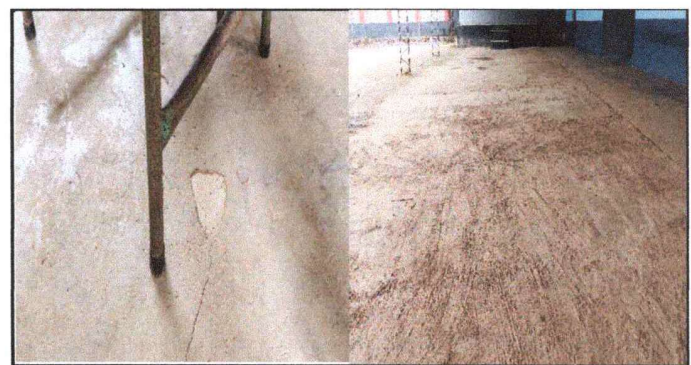
Foto 6: Sustitución de piso liso a piso ceramico y rehabilitación de piso de concreto a piso sobre piso (alisado).
